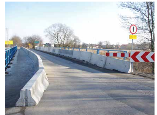
Wkrótce zostanie przebudowany most drogowy w Preczowie
