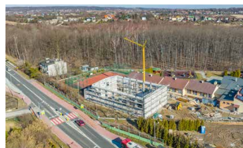
ŚCIANY SALI GMINASTYCZNEJ W GRÓDKOWIE PNA SIĘ W GÓRĘ
