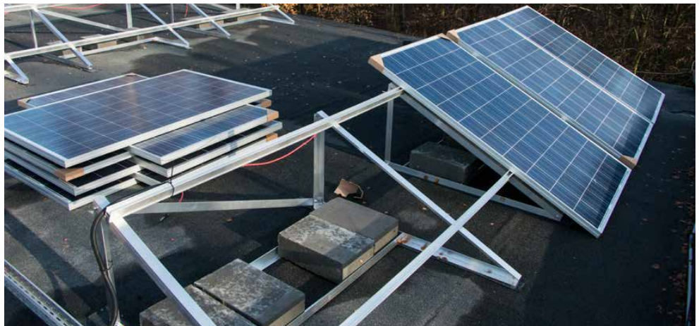
W trakcie trwania projektu zamontowano łącznie 107 instalacji OZE
