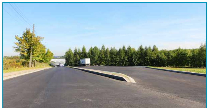
Na ul. Jasnej w Sarnowie wymieniono asfalt i powstała zatoka z miejscami parkingowymi dla ciężarówek. Inwestycję sfinansowało Gospodarstwo Ogrodnicze T. Mularski.
