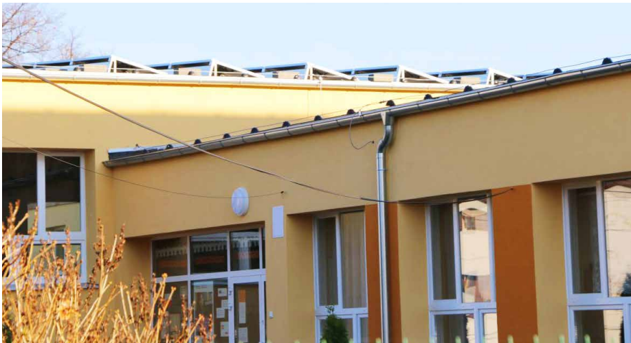
Panele fotowoltaiczne na dachu szkoły w Strzyżowicach
