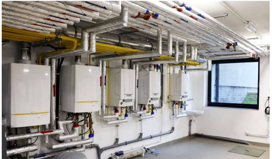
Każda instytucja ma teraz osobną instalację CO
