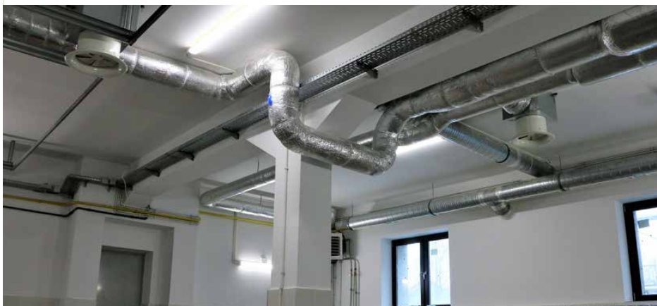
W garażach OSP położono płytki na ścianach i podłogach oraz wykonano wentylację mechaniczną
